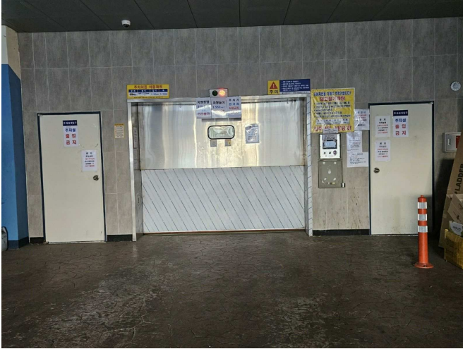
[기계식 주차장 출입구]
