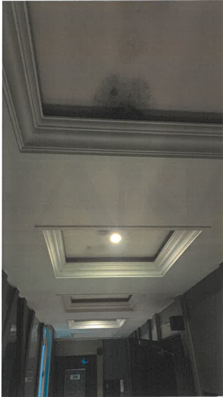
기호(3) 내부 일부 누수 등 전경
