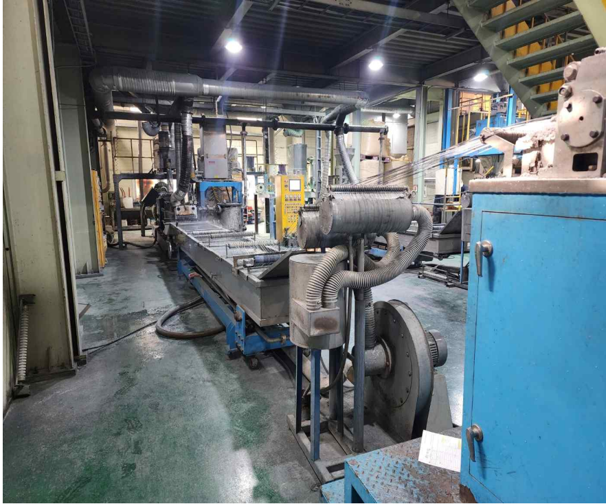
기계기구 기호2 전경
