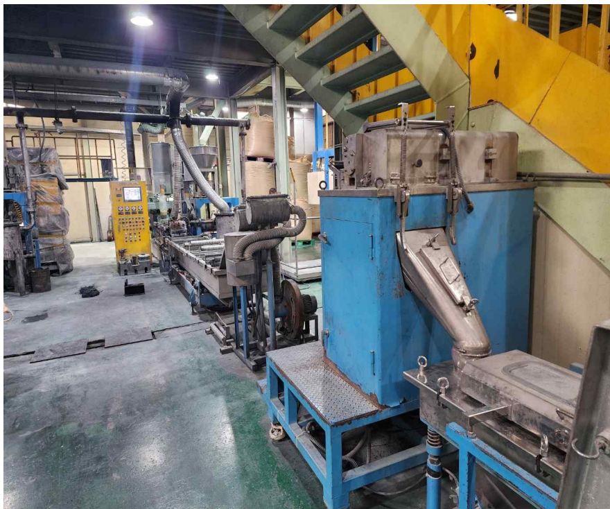
기계기구 기호1 전경
