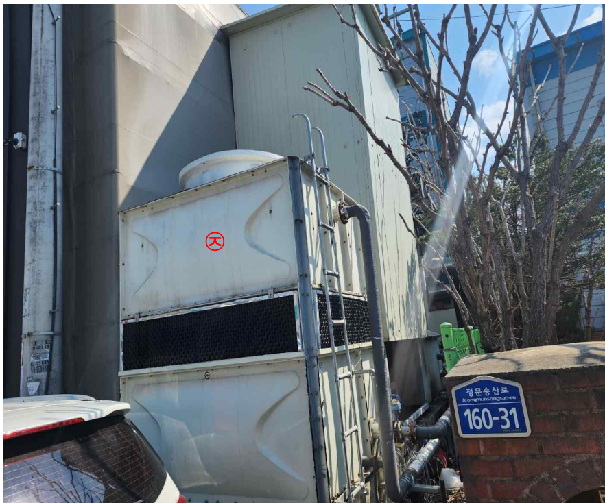
제시외기계기구 ㉕-COOLING TOWER 1식
