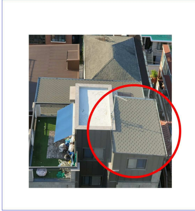
제시외물건 ㉔ 다용도실 모습 (무단증축 부분, 에이동 옥탑1층 계단실 동측 옆)
