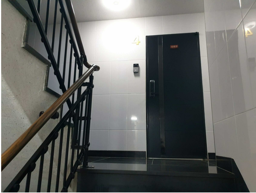
제시외물건㉠ 비이동 4층 무단증축 주택 (402호~404호 부분 벽면 모습)
