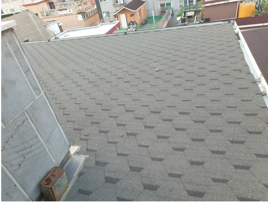
비이동 4층 무단증축부분의 지붕 모습
